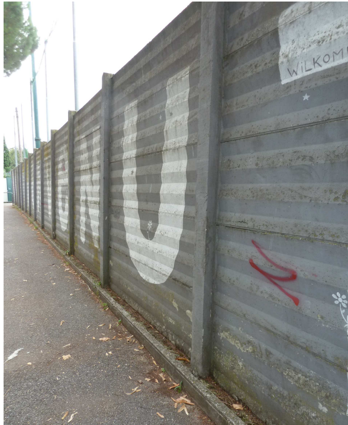
pannelli prefabbricati in cls armato con pali di sostegno in cls armato
